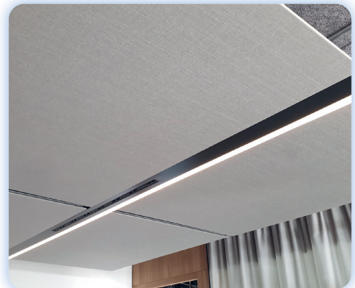
Typische Anwendungen sind Bürogebäude, Schulen, öffentliche Gebäude und Flughäfen, in denen 50–75% der Deckenfläche mit Heiz- und Kühlpaneelen belegt sind.
