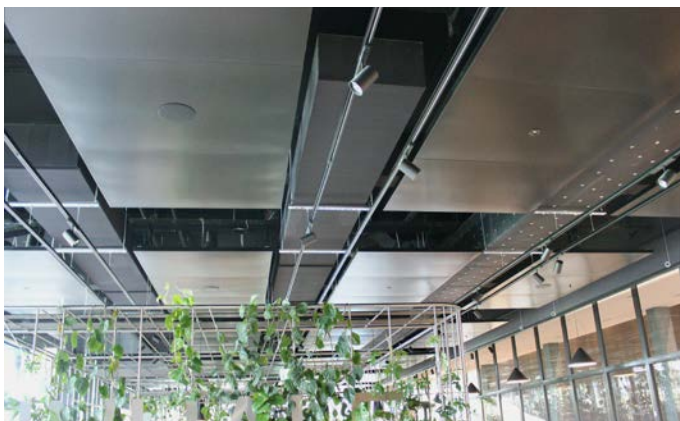
Bild 2: KKS ... mit eingebauten Lautsprechern und Leuchten.
