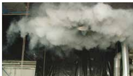
Jet horizontal en mode refroidissement
