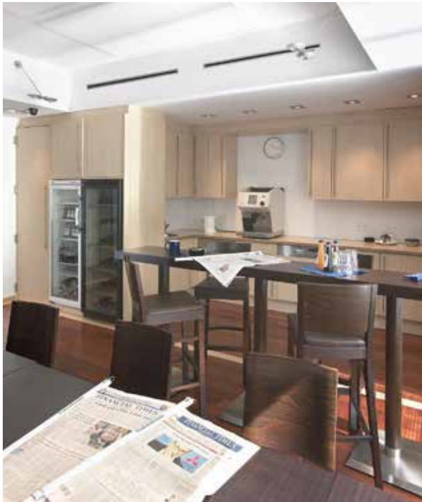
Figure 2: Diffuseur mural à fentes dans la cafétéria d'un immeuble de bureaux
