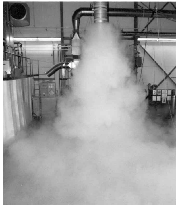
Figure 5: Propagation des jets d'air mise en évidence avec de la fumée,
