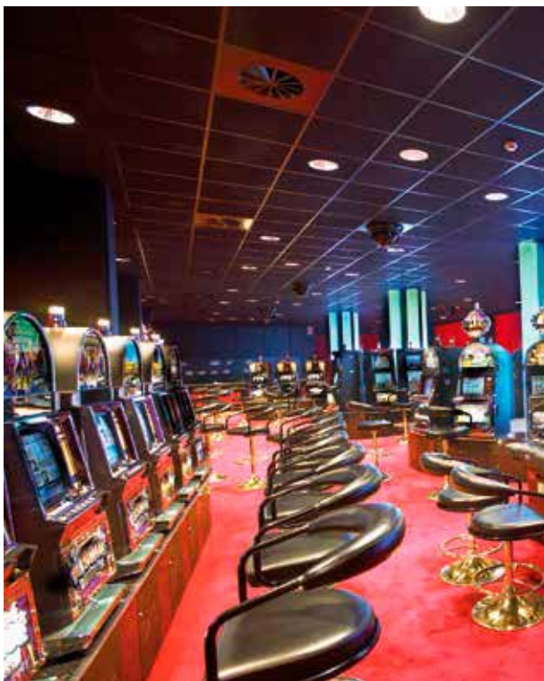
Diffuseurs radiaux à face apparente carrée dans un casino
