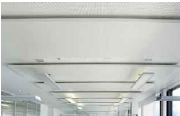
Figure 7: Voiles multifonctions coulissées sur les traverses
