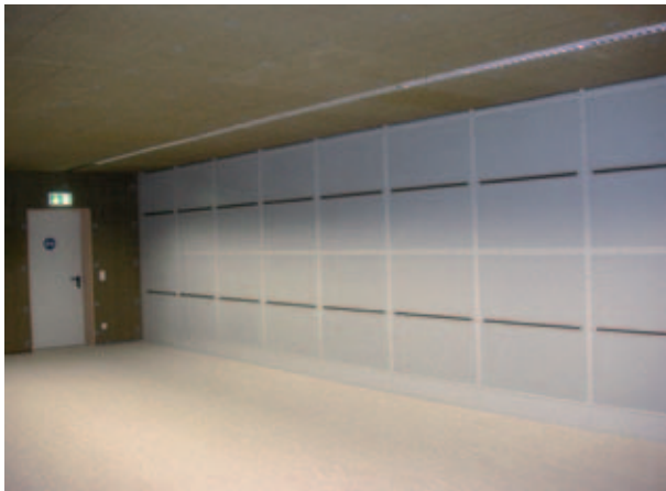
Luftauslasswand mit Lochblechkassetten und Induktivauslässen
