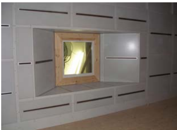
Luftauslasswand mit Lochblechkassetten und Induktivauslässen. Schützenaufsichtsfenster mit luftführenden Laibungen.
