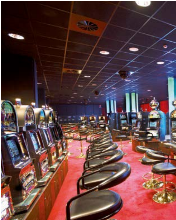
Radialauslass mit quadratischer Sichtfläche in einem Spielkasino
