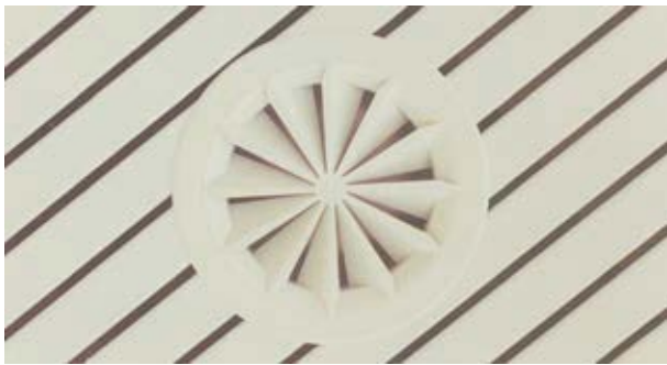
Radialauslass in einer Paneeldecke
